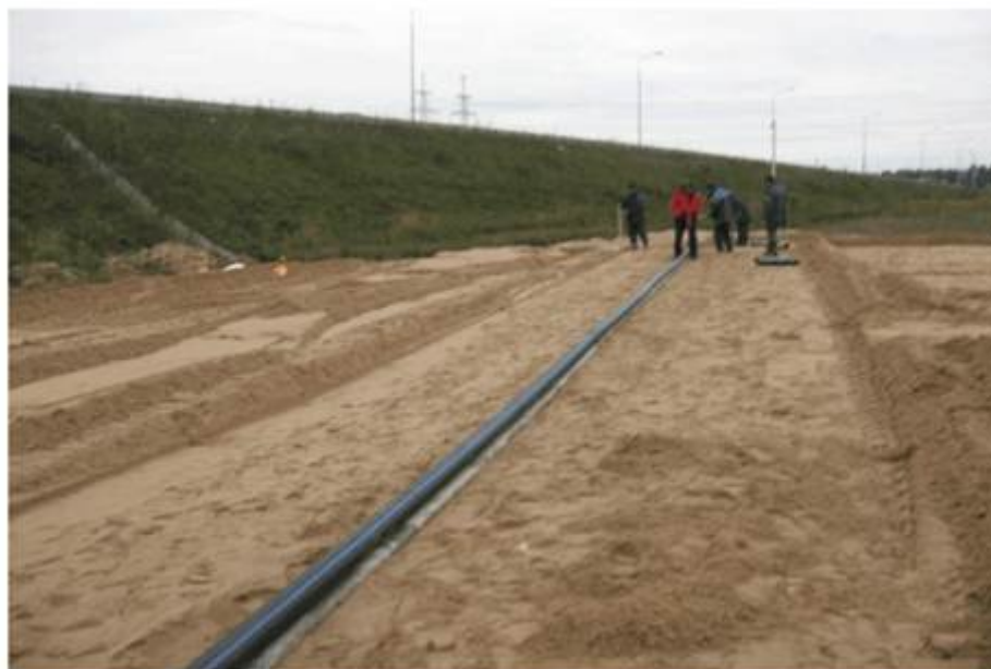
Рисунок 14 Устройство измерительного канала на КАД г. Санкт-Петербурга
